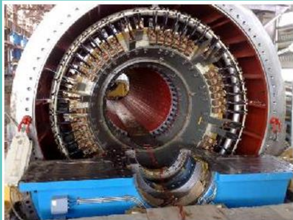
Gambar 2. Generator di dalam PLTA
