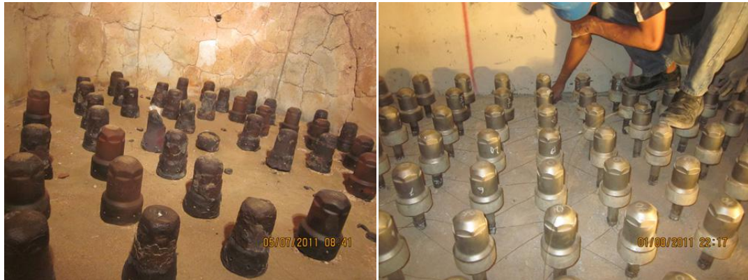
Gambar 2.32 Pengecekan F.A Nozzle Sealpot & yg sudah diperbaiki
